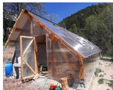
SERRE « 3 MURS » Péone (06)
